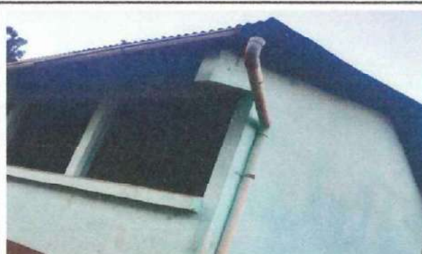
Foto 2: Pintura de las paredes en mal estado
