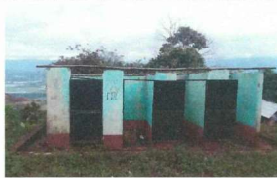
Foto 4: Baños o Sanitarios en mal estado (Techo y accesorios)
