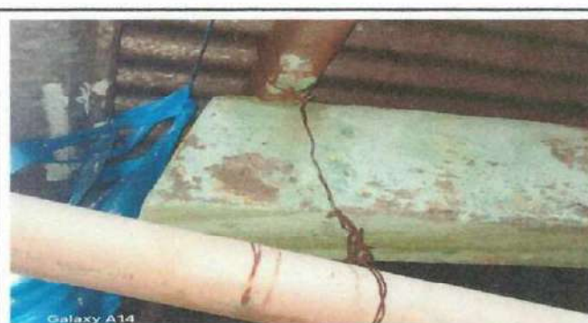
Foto 6: Estructura de techado en mal estado
