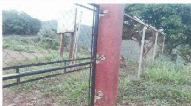
Foto 3: Estructura metalica de circulacion perimetral en mal estado.
